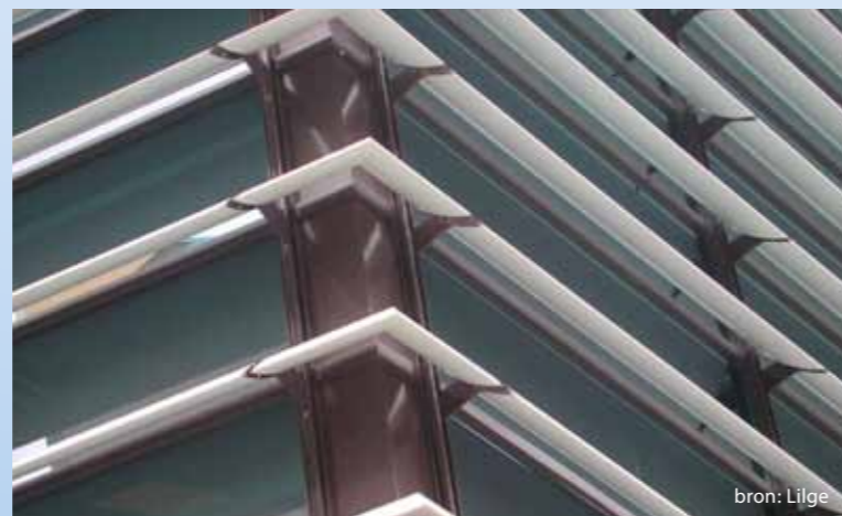
Zonwering door lamellen aan de gevel
