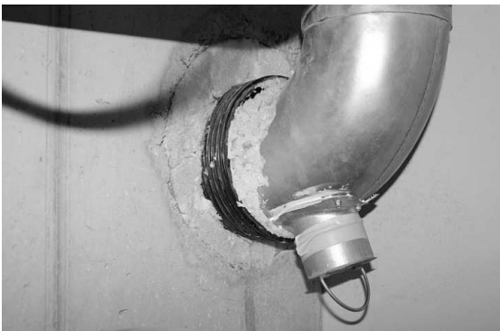
Abb. 6: Nicht fachgerechte Ausführung des Anschlusses des gerippten Rohres eines LEWT an die Verrohrung zum Lüftungsgerät im Keller eines Einfamilienhauses (Tappler 2005)
