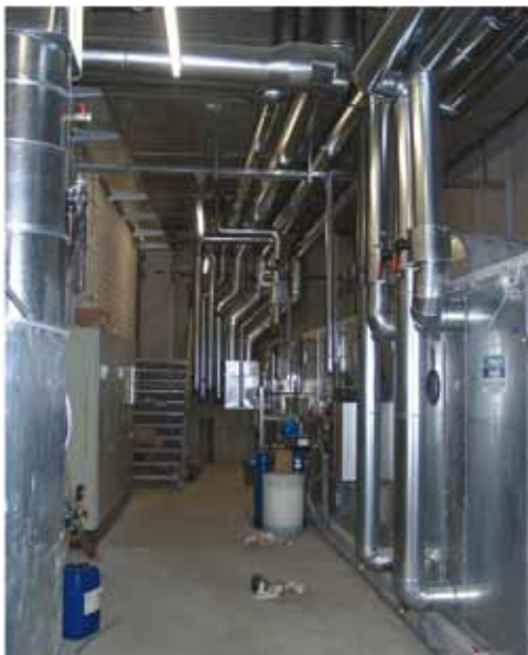
Abb. 3 Lüftungszentrale ENERGON (Quelle: ebök)
